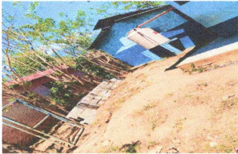
foto 3. el trabajo realizado se esta perdiendo por no terminarlo
