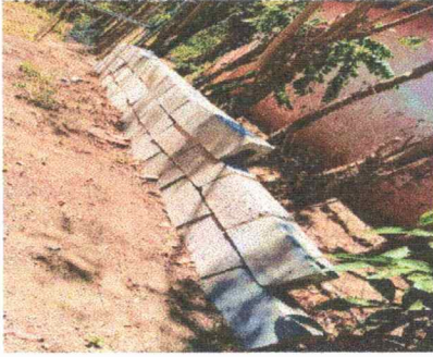
foto No. 1 se observa el desgaste y deterioro de el muro
